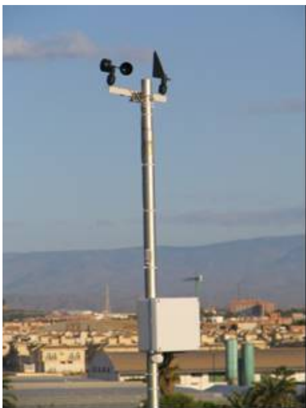
Figura 7.1. Instalación realizada para la monitorización del C-DdI CIESOL. Sensores de velocidad y dirección de viento.
