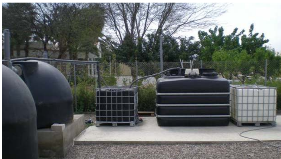
Figura 3.3. MBR instalado para regenerar agua procedente de guardería de la UAL.
