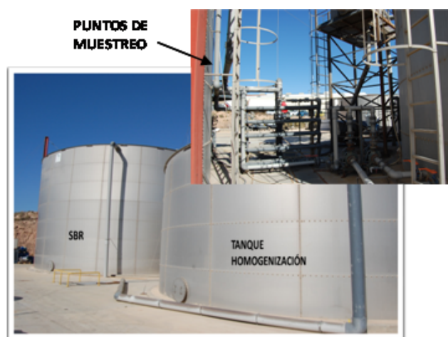
Figura 6.3. Sistema de depuración biológico (SBR) localizado en Cítricos del Andarax, S.L. Detalle de los puntos de muestreo de los tanques.
