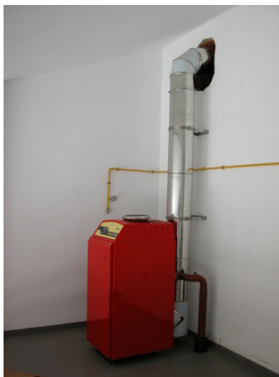
Fig. 4.3.4. Caldera de gas natural.
