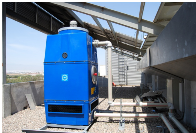
Fig. 4.3.6. Torre de refrigeración Sulzer EWK 100.
