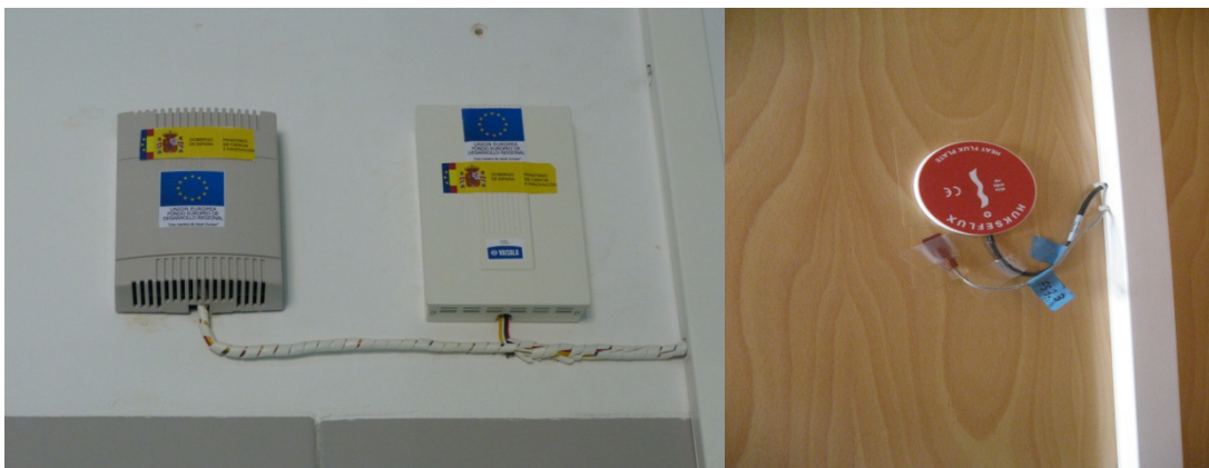
Fig. 4.3.20. Sensores de humedad relativa, CO2 y flujo térmico.
