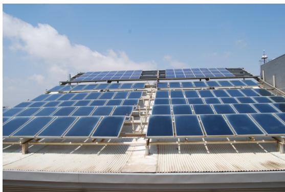
Fig. 4.3.2. El campo solar constituido por 80 captadores Solaris CP1 y 42 módulos fotovoltaicos.
