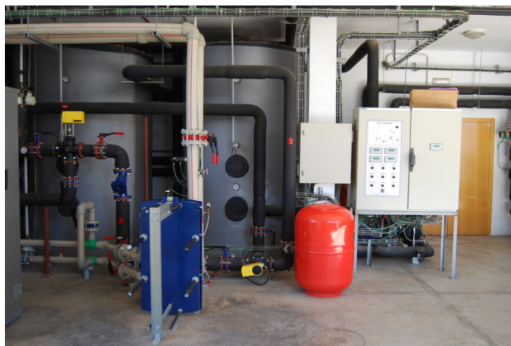
Fig. 4.3.3. Dos tanques de acumulación de agua caliente de 5000 litros cada uno.
