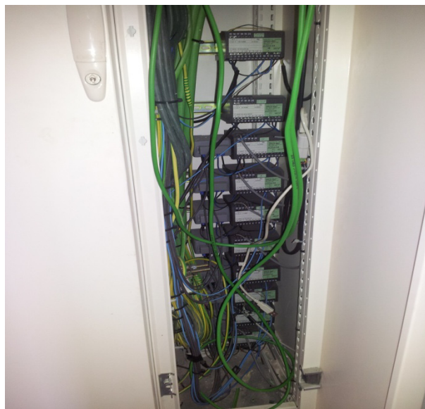
Fig. 4.3.21. Watímetros instalados para analizar los consumos eléctricos.
