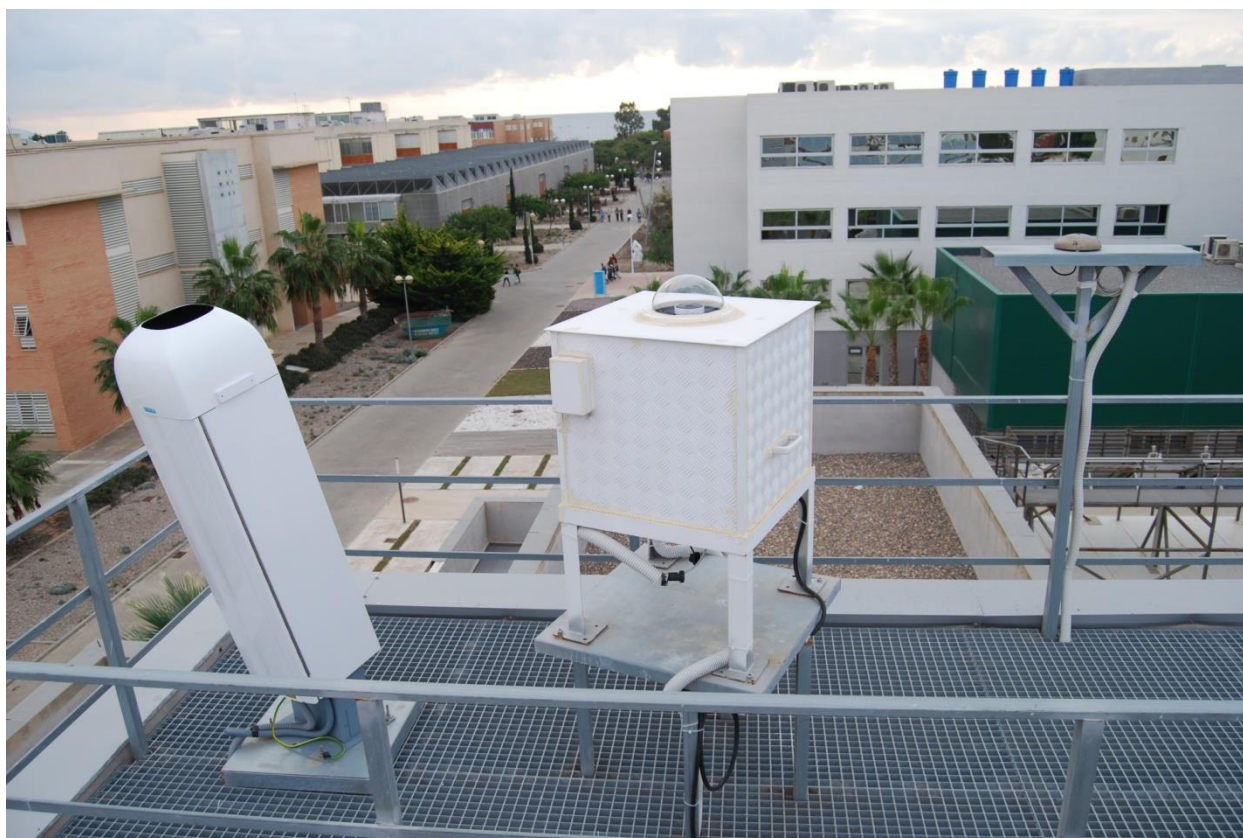
Figura 3.3.8. Estructura metálica instalada en la azotea del edificio CIESOL conjuntamente con el ceilómetro VAISALA CL-51 (izquierda), cámara de cielo ASTMON (centro), cámara de cielo MOBOTIX Q24 (derecha).
