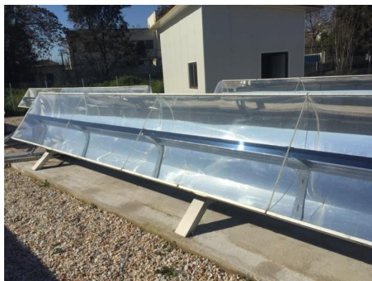
Figura 2.6.8.1. Captadores CPV/T de Absolicon utilizados en el proyecto CPV-Rankine
