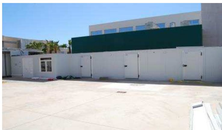
Tres cámaras piloto de frigoconservación y la cámara de control (vista frontal) instaladas en el patio del edificio CIESOL.
