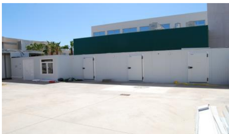
Cámaras piloto de frigoconservación y la cámara de control (vista frontal) instaladas en el patio del edificio CIESOL.
