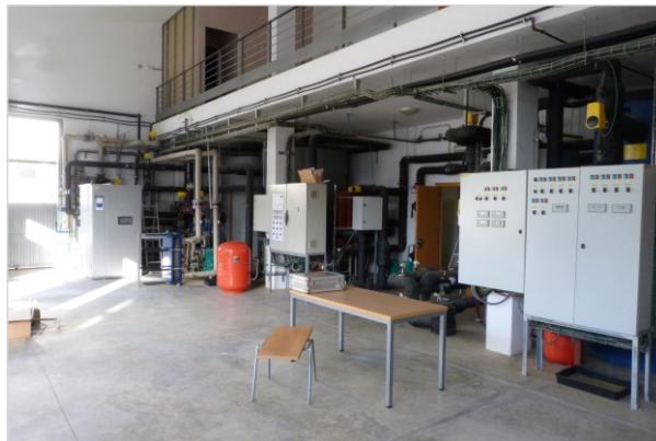
Nave CIESOL – Instalación de frío solar
