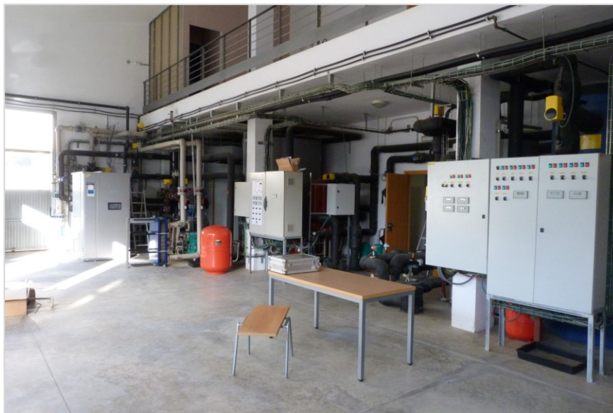
NAVE CIESOL – Instalación de frío solar
