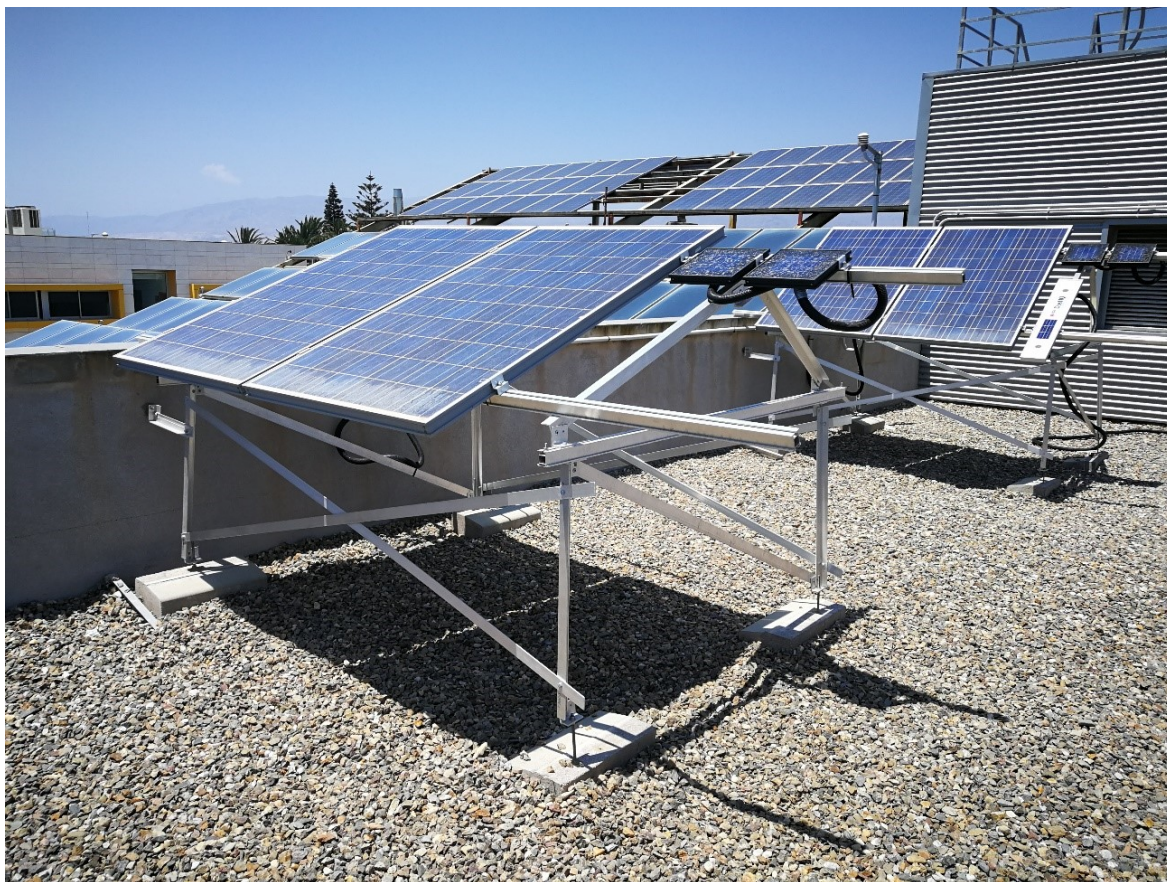
Fig. 2.5.3. Planta piloto fotovoltaica con los sensores.
