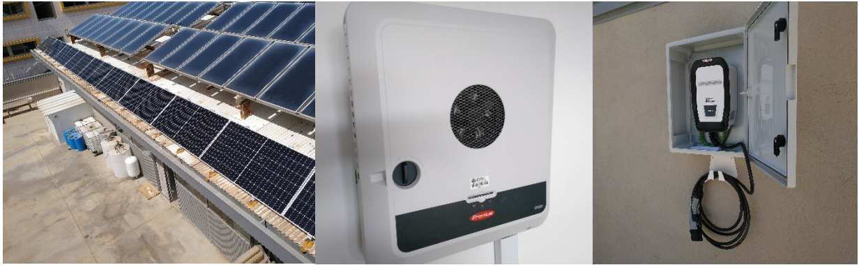
Módulos fotovoltaicos, inversor-cargador y punto de recarga de vehículo eléctrico.
