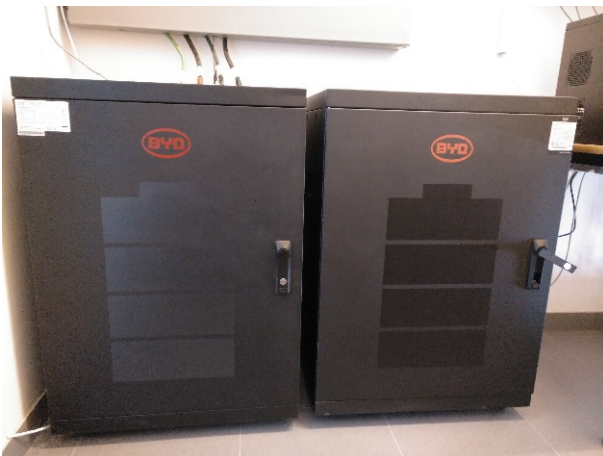
Baterías de Litio para almacenamiento de electricidad
