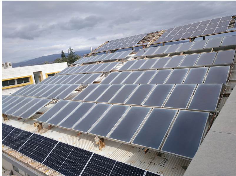
Campo de colectores solares
