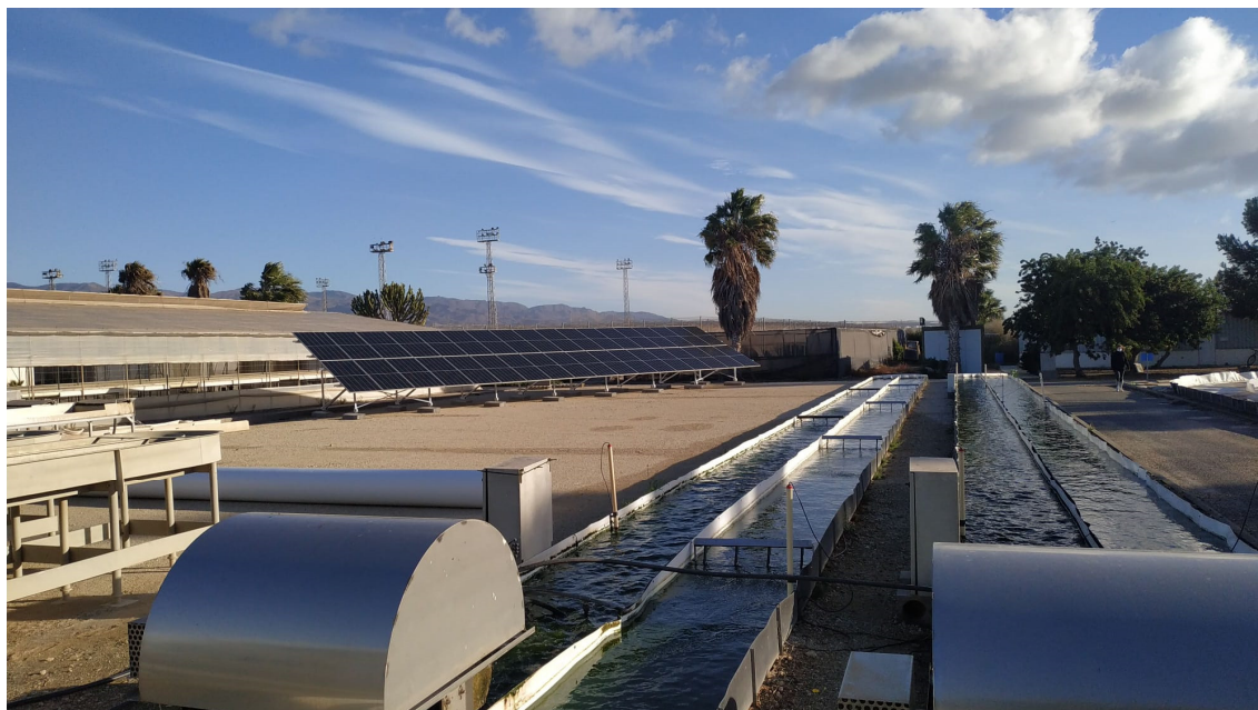
Nuevo campo fotovoltaico Agroconnect y fotobiorreactores del proyecto SABANA
