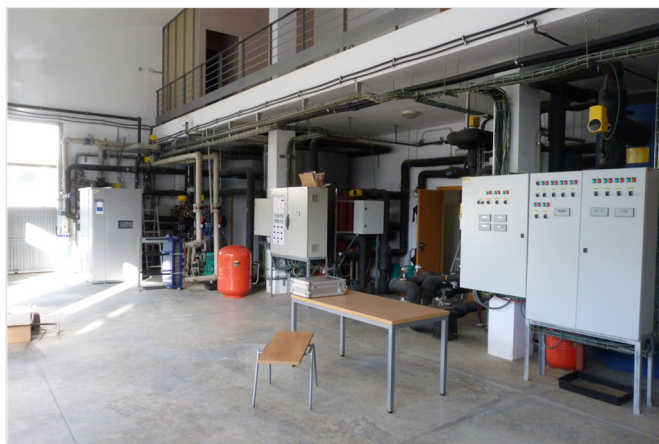
NAVE CIESOL – Instalación de frío solar
