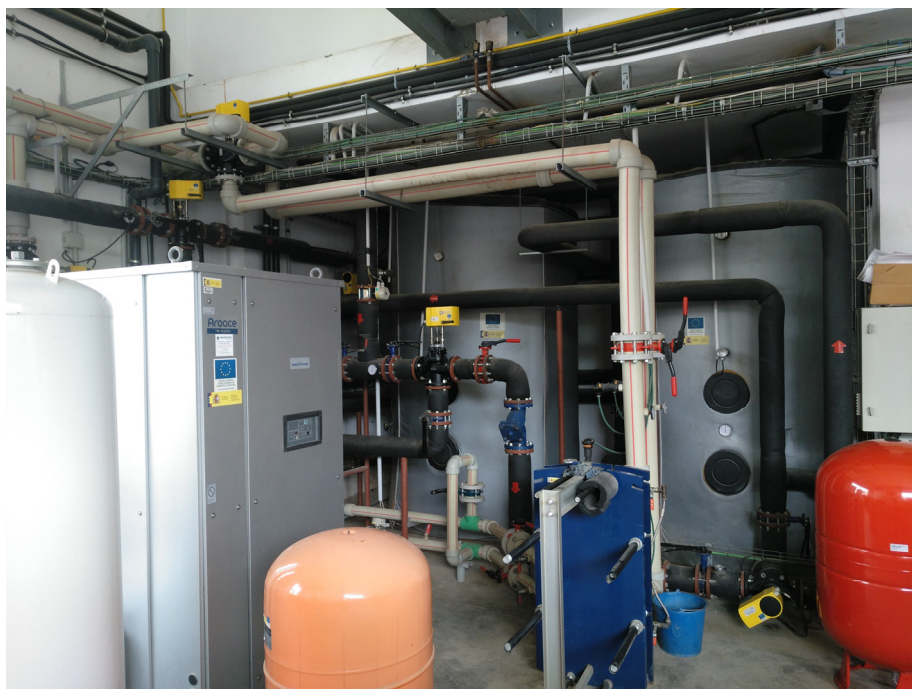
Máquina de absorción Yazaki (izquierda) y tanques de almacenamiento de agua caliente (derecha)
