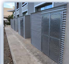
CASETAS DE GASES
