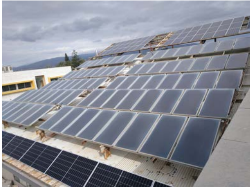
Campo de colectores solares
