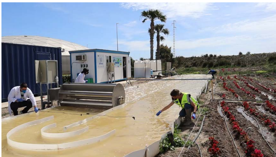
Figura 2.3.1. Fotorreactor tipo canal para la operación del proceso foto-Fenton solar en modo continuo para el tratamiento de aguas depuradas, instalado en la EDAR “El Bobar” de Almería.
