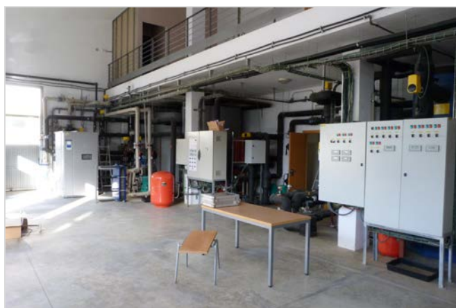
NAVE CIESOL – Instalación de frío solar
