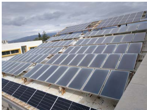
Campo de colectores solares
