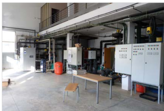
NAVE CIESOL – Instalación de frío solar
