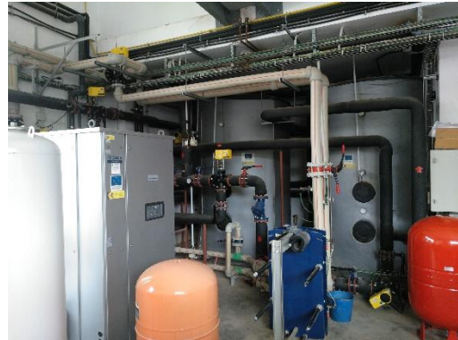
Máquina de absorción Yazaki y tanques de almacenamiento de agua caliente
