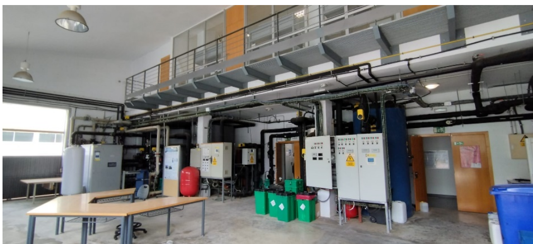
NAVE CIESOL – Instalación de frío solar
