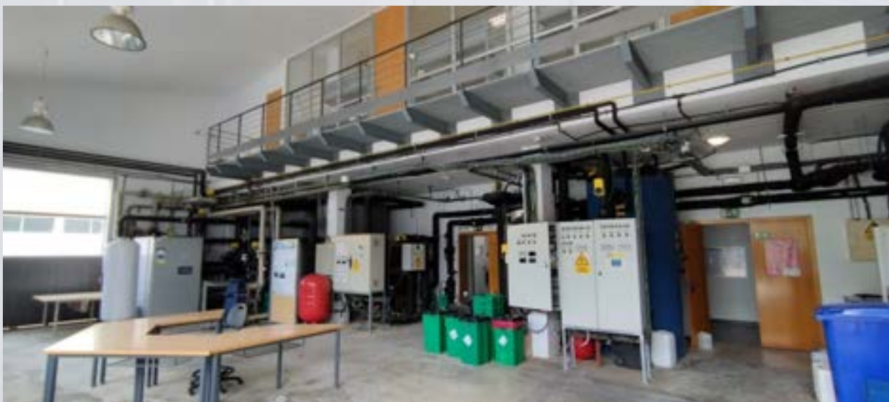
NAVE CIESOL – Instalación de frío solar
