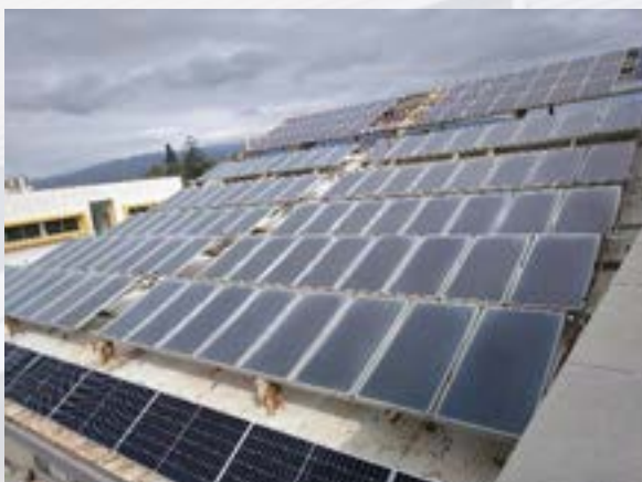
Campo de colectores solares
