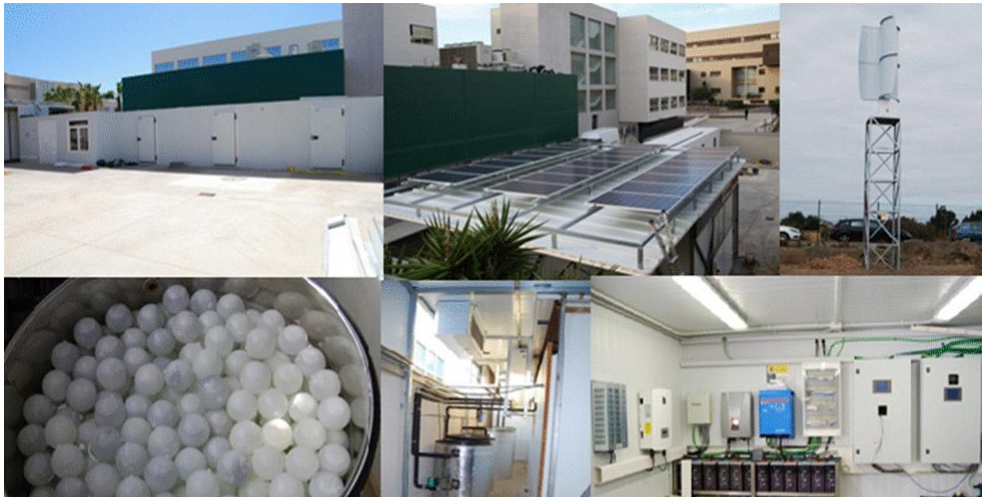
Diferentes partes del sistema de refrigeración solar de CIESOL.
