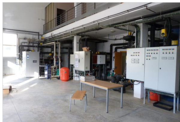
Nave CIESOL – Instalación de frío solar
