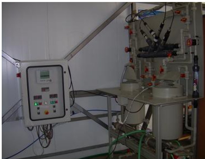
Figura 3.3. Fotografía del cerramiento en el que se ubican las plantas gemelas para foto-Fenton.
